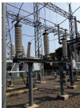
変電所に設置されている避雷器(提供:中部電力)
