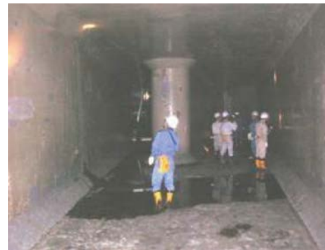
取水路(取水時)
