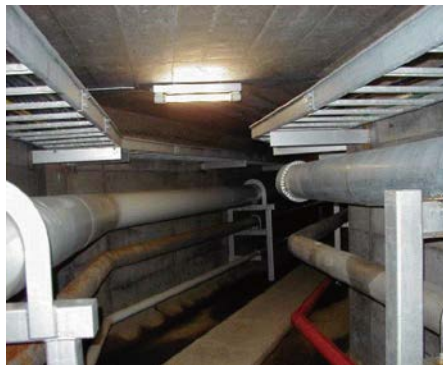
海水管ダクト
