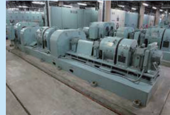
大容量発電機模擬装置
