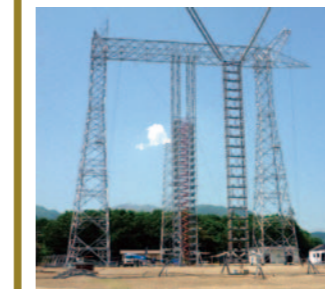
衝撃電圧発生装置
