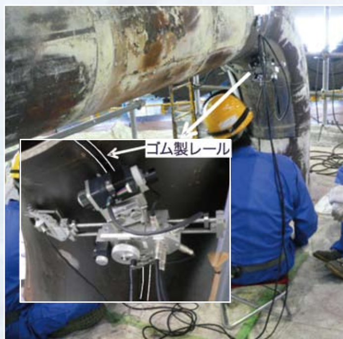
火力発電所高温再熱蒸気管エルボ長手溶接部への適用事例
