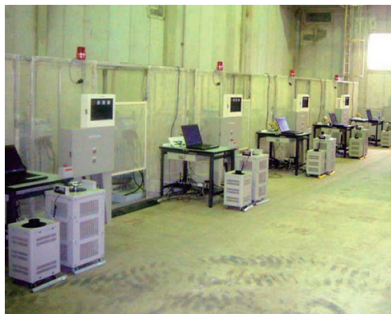
課電自然循環洗浄試験に用いた課電装置
