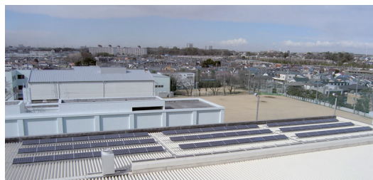
太陽光パネル(4.5kW×3セット)
