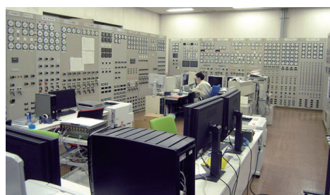
電力系統シミュレータ 2階制御室
