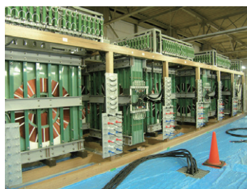
66kV送電線模擬装置(40km×6組) ▶40kmは等価的に約9kmに相当
