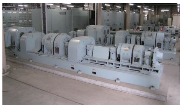
大容量発電機模擬装置
