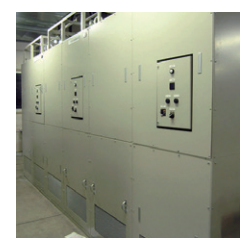
負荷用変圧器(60kVA×3台) 3.3kV/1.65kV/200V 負荷時タップ切替器付(9タップ)
