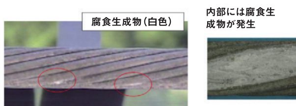
図4-4 腐食生成物由来の白色と電線内部
