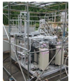
図2 実規模過熱配管を用いた小規模実証試験(九州・滝上発電所)
