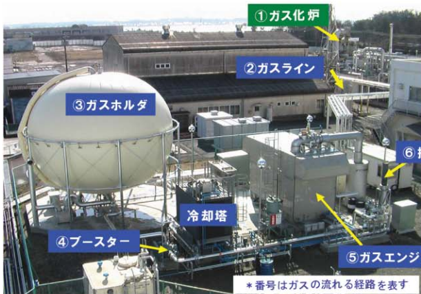
a) ガスエンジン発電実証実験設備 （関西電力共同研究）
