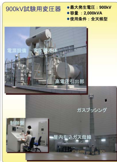
900kV 試験用変圧器
