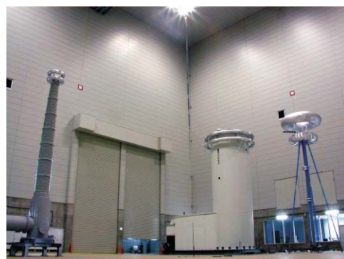
大ホール(900kV変圧器二次ブッシングと2600kVインパルス電圧発生装置)
