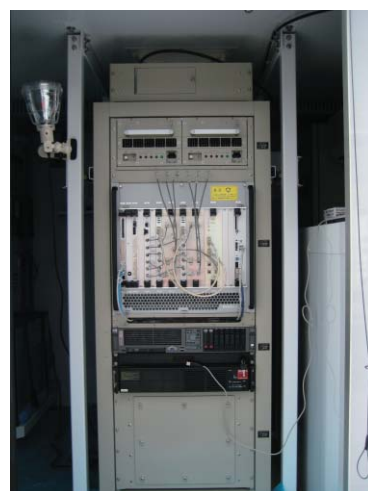
レーダ制御装置
