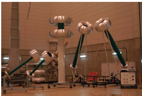
超高圧級CVケーブル課電試験用標準コンデンサおよび水端末試験設備
