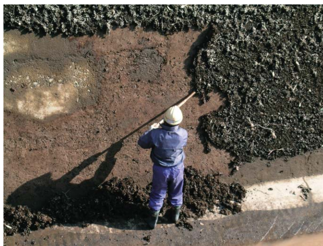
図2 発電所の導水路に大量に張り付いたカワヒバリガイ
