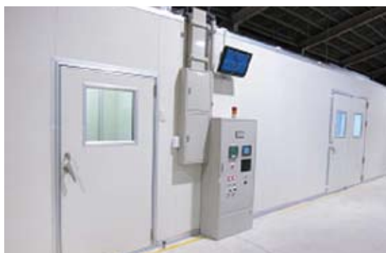
写真1 高気密恒温恒湿室および制御・モニタリング装置の外観
