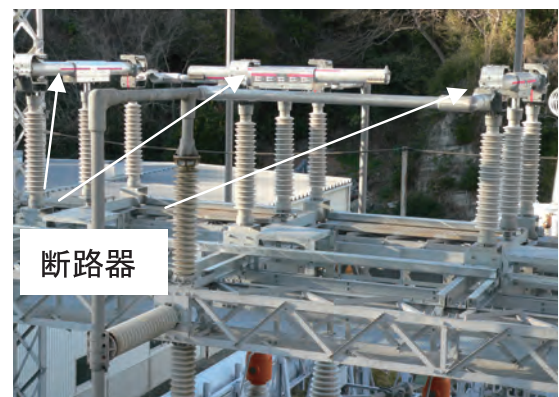
115kV水平断路(3機連動)
