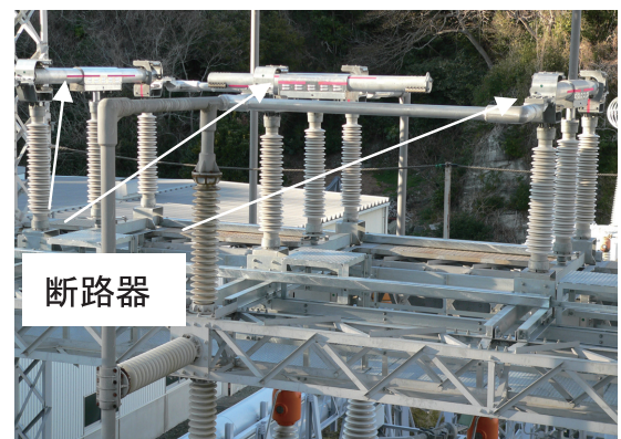
115kV水平断路(3機連動)
