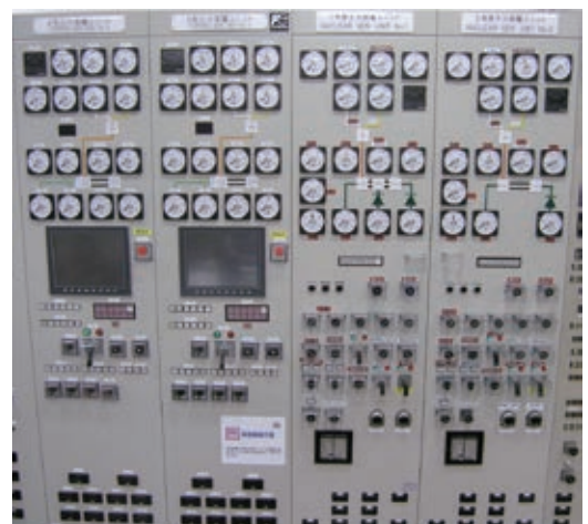
発電機運転操作盤
