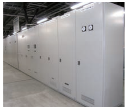
原子力機制御盤
