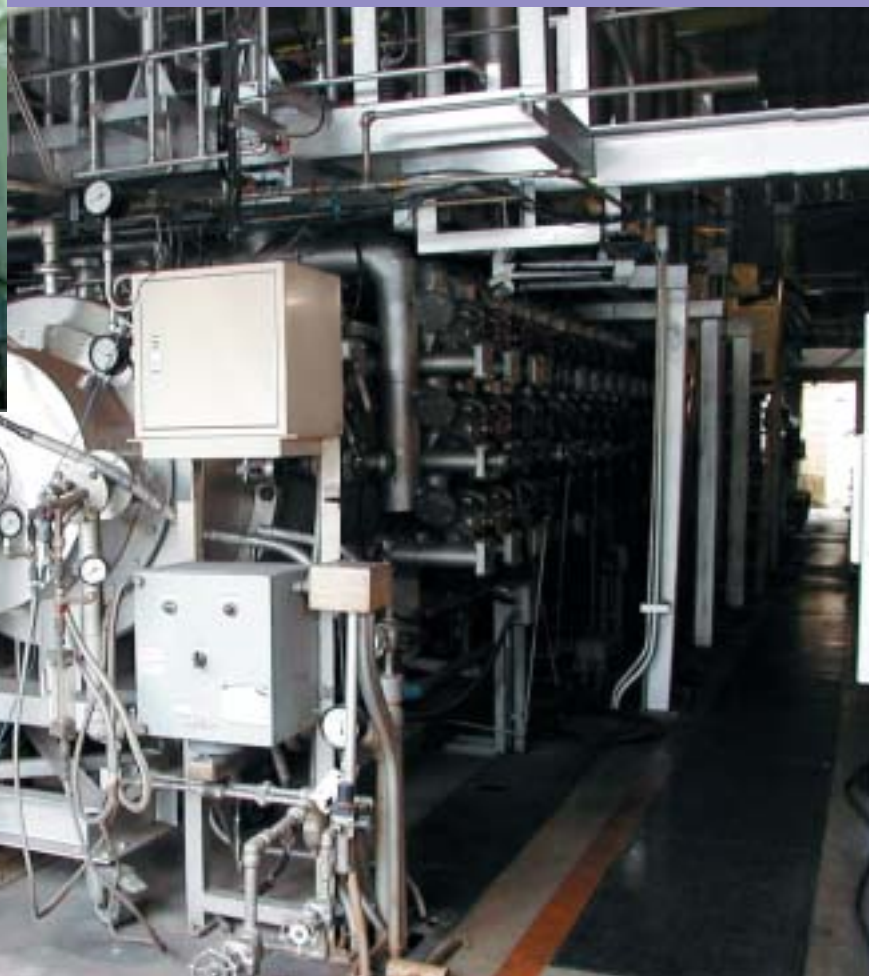
* 石炭燃焼特性実証試験装置 (MARINE炉) (上) と * 石炭燃焼試験設備 (BEACH炉) (下)
