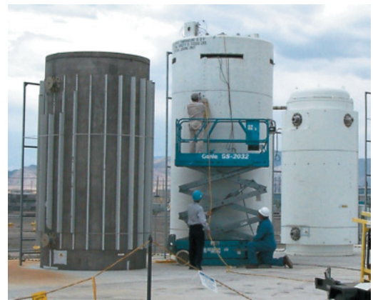
図7-2-1 コンクリートキャスクの非破壊検査の様子
