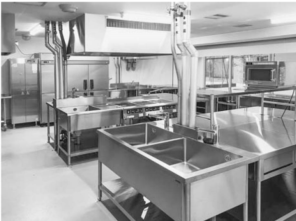
我孫子地区に新設した職員食堂（右）。換気量を抑制した厨房（左）は、省エネ型モデル施設として活用していく
