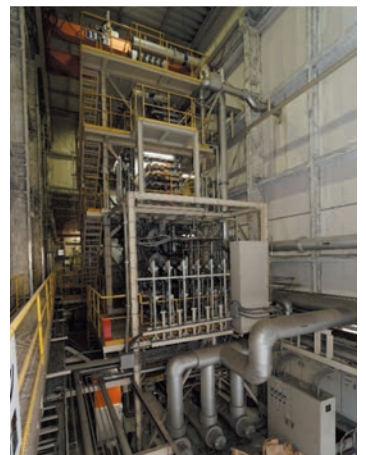
石炭燃焼特性実証試験設備
